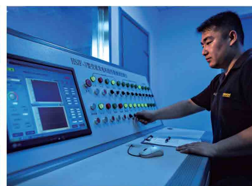
发电设备检测中心
